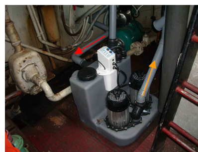
Photo 7 : pompe de relevage d'un bateau restaurant raccordé à une borne (Port de l'Erdre, Nantes)
