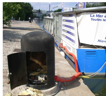
Photo 6 : borne de récupération des eaux usées (Port de l'Erdre, Nantes)
